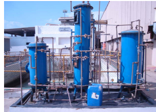
Equipamento de desmineralização de água.
